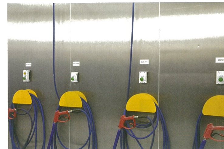
De vier spuitlansen gekoppeld aan de benodigde tanks.
